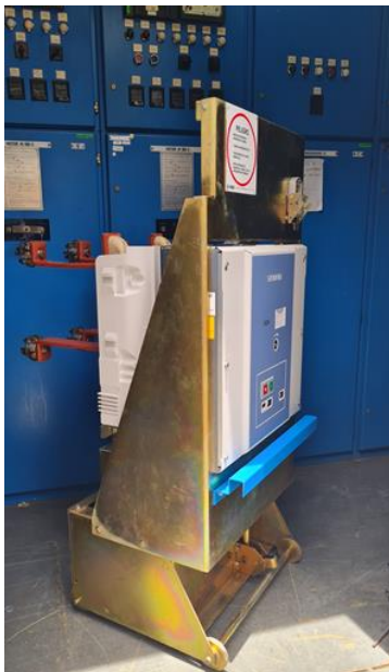
Modernización de carros de celdas de media tensión
